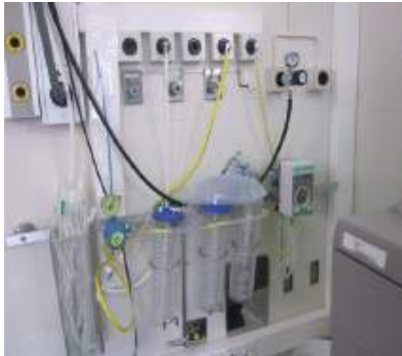
Conexión extractor de gases y tomas de vacío, O2, aire medicinal
